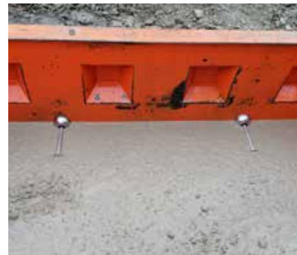
3 El anclaje está fundido en su totalidad, tenga cuidado con la vibración del hormigón
